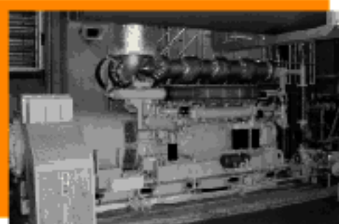
非常用発電機
